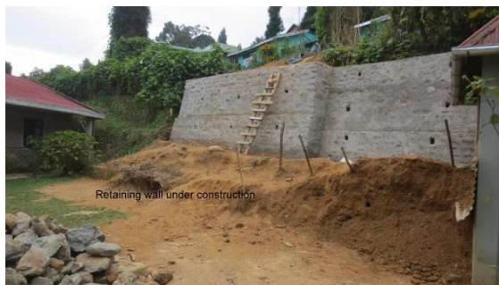
Ny mur efter jordskred
